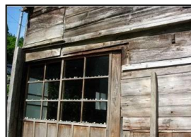
②窓ガラスの割れ
