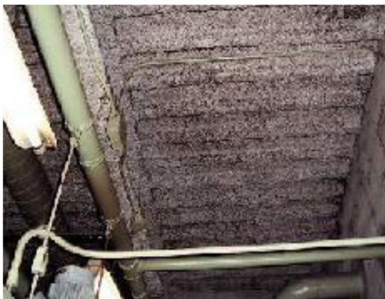
石綿含有吹付けロックウール
