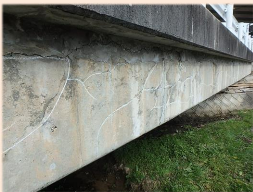
床版部のひび割れ
