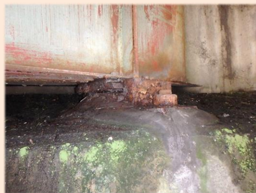
支承部の腐食
