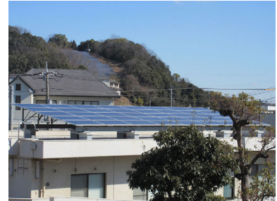
太陽光発電設備（消防機庫）
