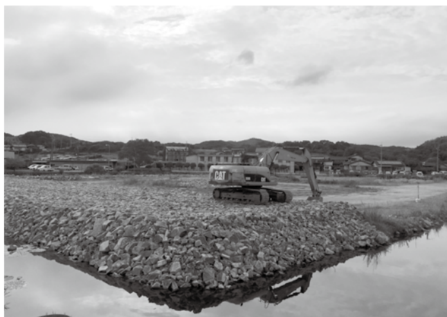
埋め立てが進む天草池
