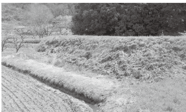
イノシシに荒らされたため池の堤
