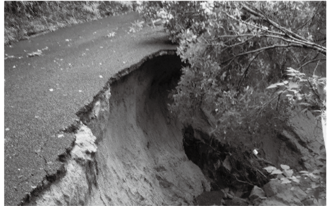
市道日原2号線の崩壊
