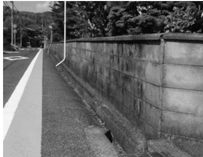
通学路沿いの老朽化したブロック塀
