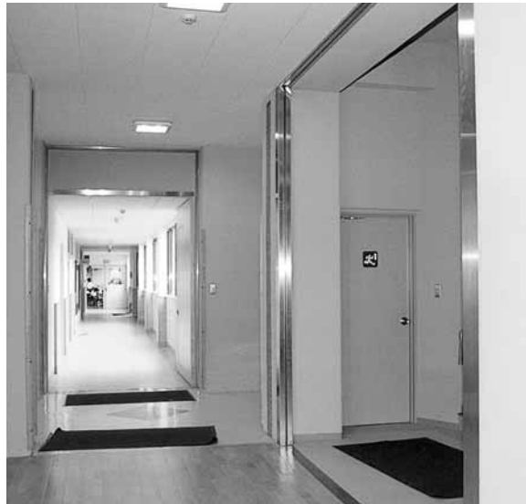
六条院小学校防火シャッター
